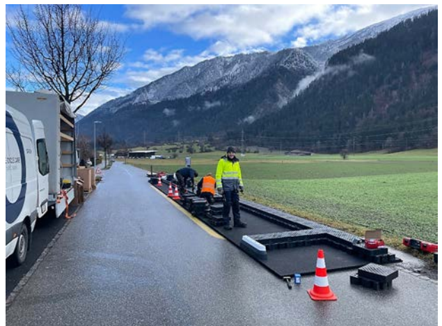
Puzzleähnlicher, hindernisfreier Haltestellenaufbau Quadras (provisorisch)
